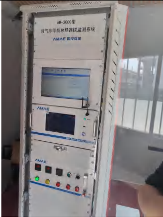
非甲烷在线设施
